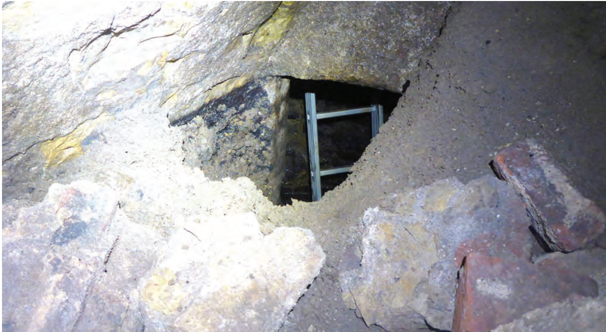
Foto 243: Technischer Bereich, unterirdischer Raum an Brunnen (S5)
