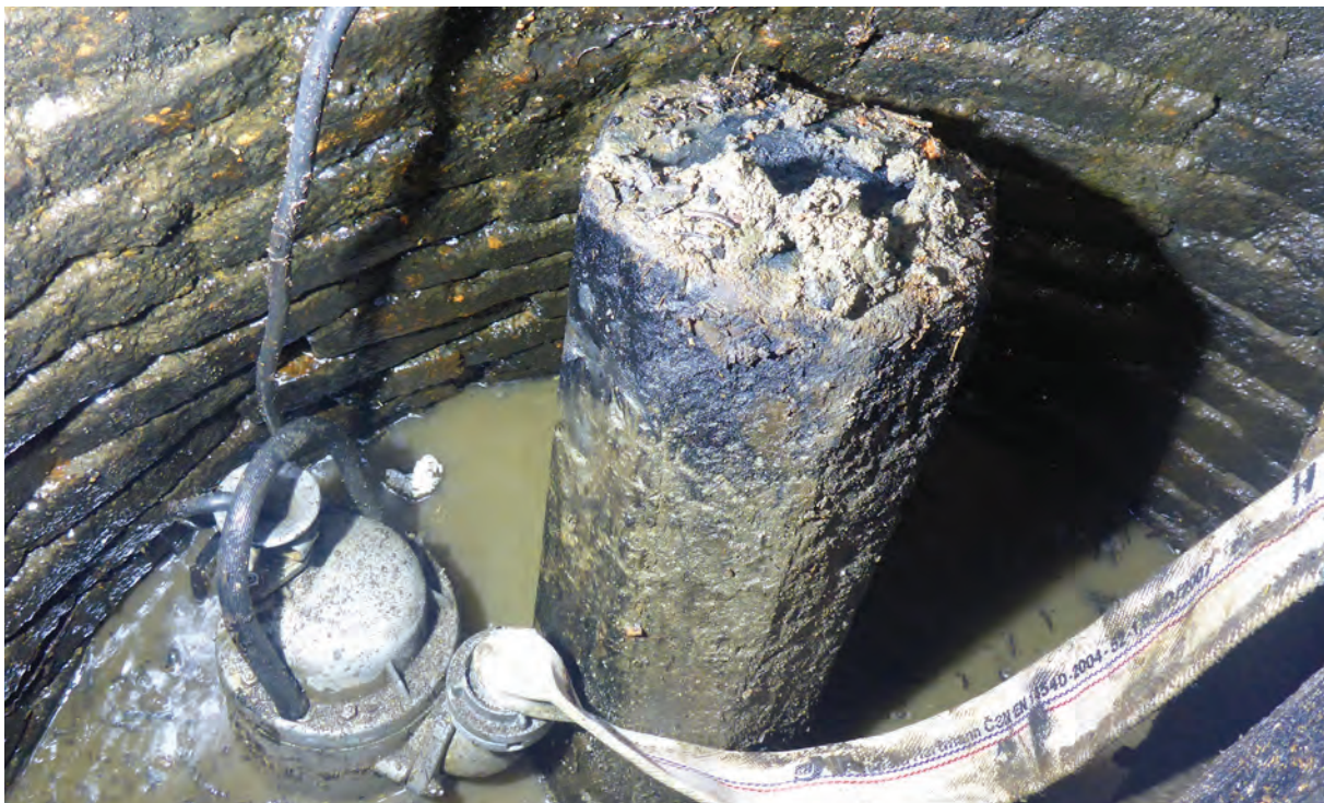
Foto 242: Technischer Bereich, Brunnen (S5)
