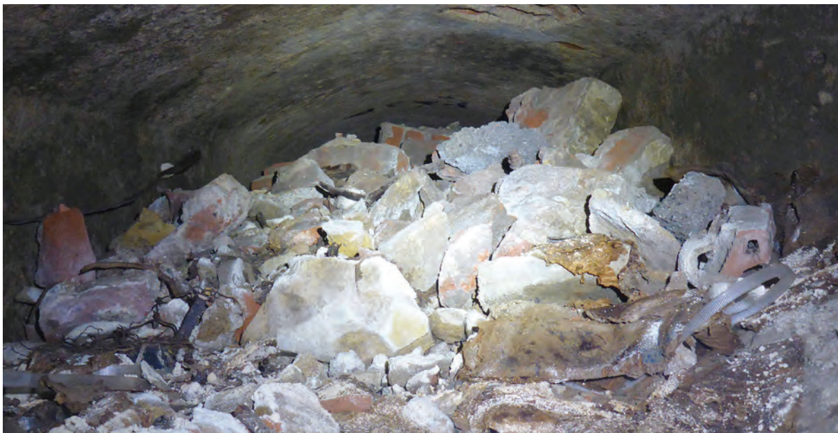
Foto 244: Technischer Bereich, unterirdischer Raum an Brunnen (S5)
