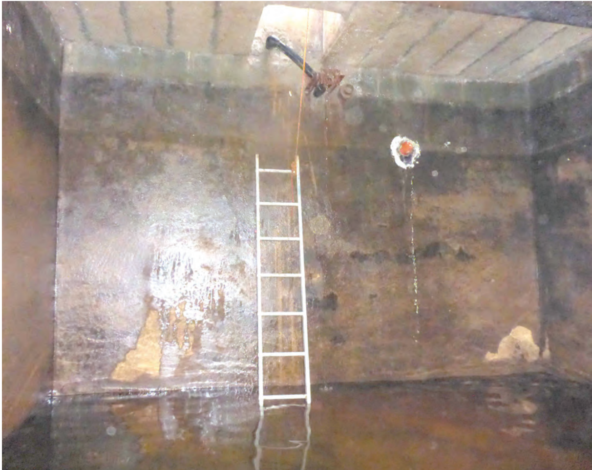
Foto 224: Haus Nazareth, oberste Terrasse, unterirdischer Wasserbehälter ( vodojeme 1 )
