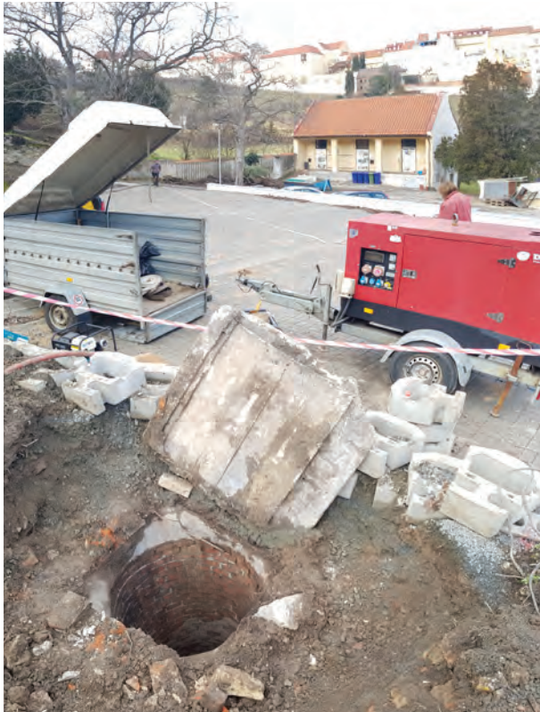
Foto 239: Technischer Bereich, Brunnen (S5)
