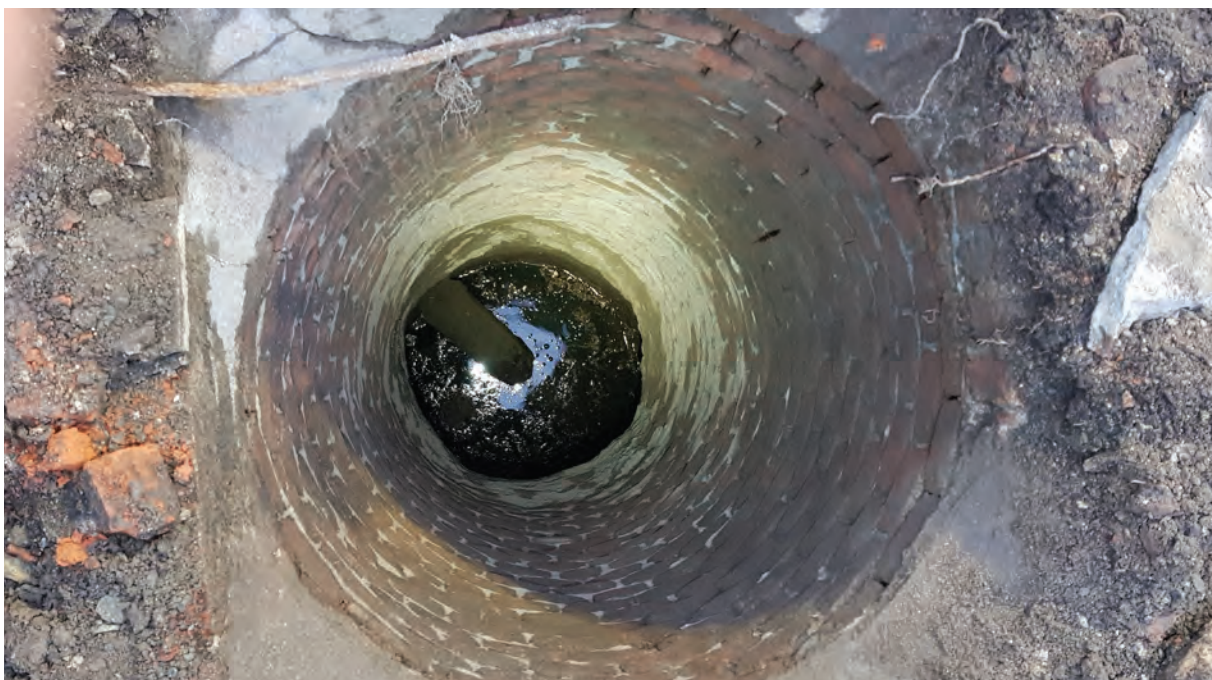
Foto 240: Technischer Bereich, Brunnen (S5)
