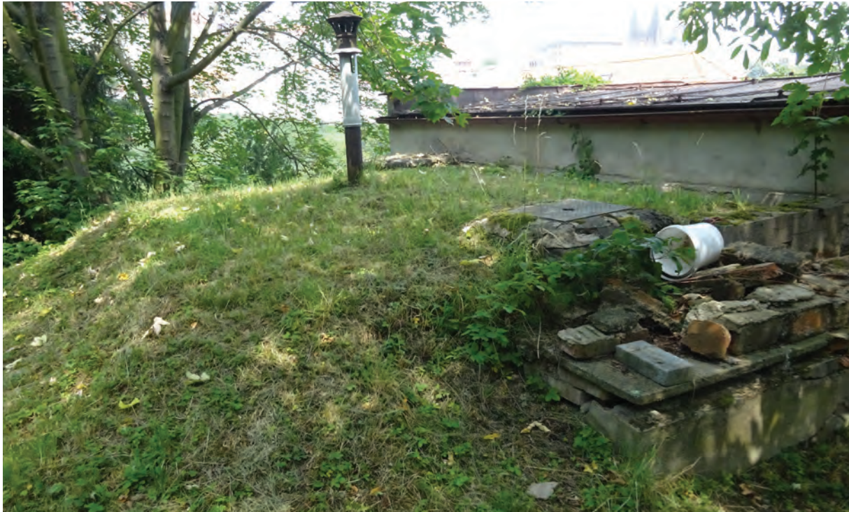
Foto 222: Haus Nazareth, oberste Terrasse, unterirdischer Wasserbehälter mit Zugang und Abluftschornstein
