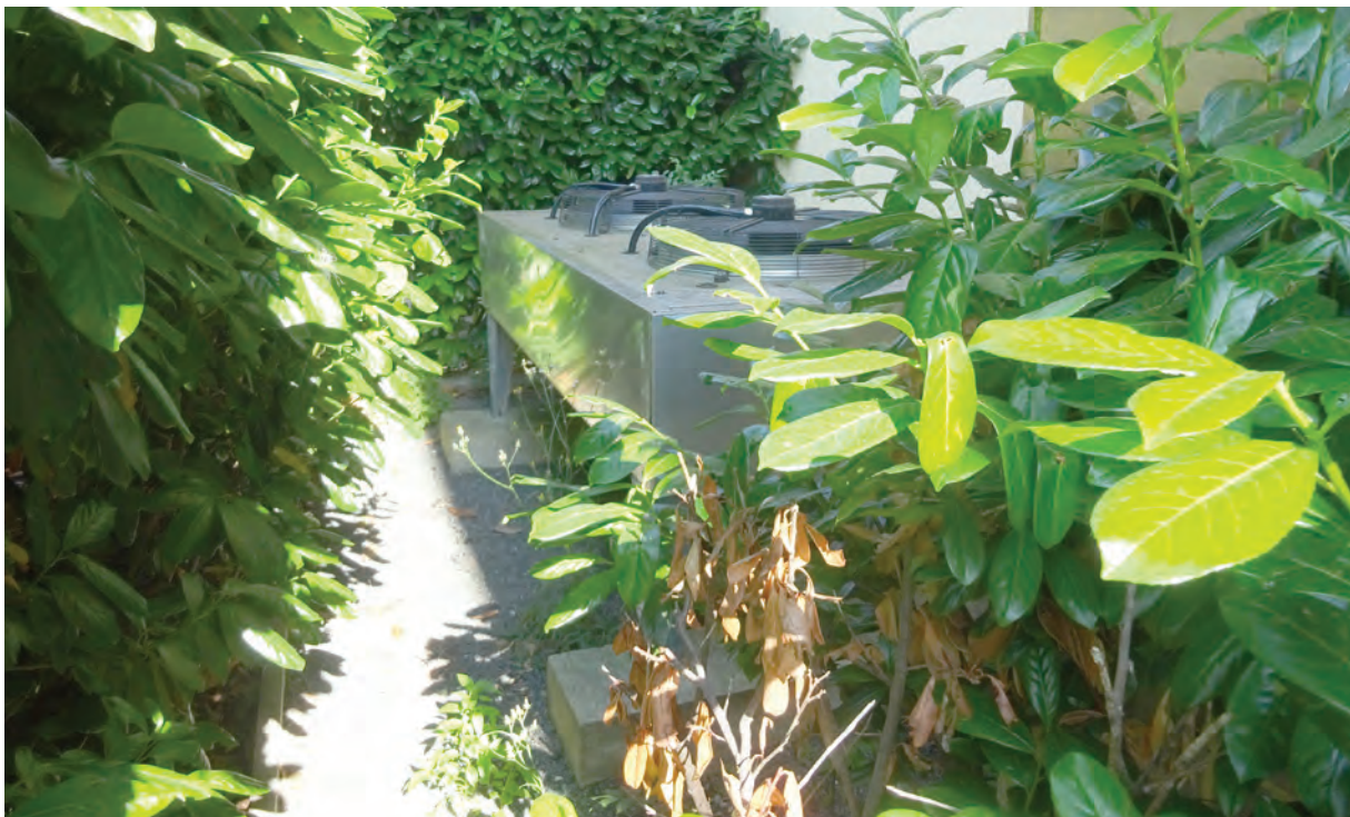
Foto 084: Krankenhausthof, Klimaanlage, Nordfassade des St. Antonius-Flügels
